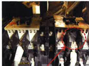
接点の消耗による軽度の焼損
